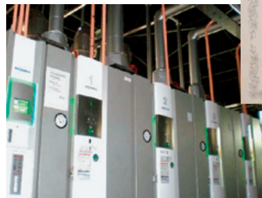
ガスボイラー
